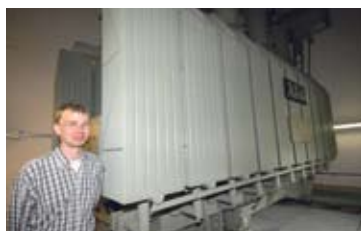
Sven Petersen von den Stadtwerken kontrolliert regelmäßig die Schaltelemente
