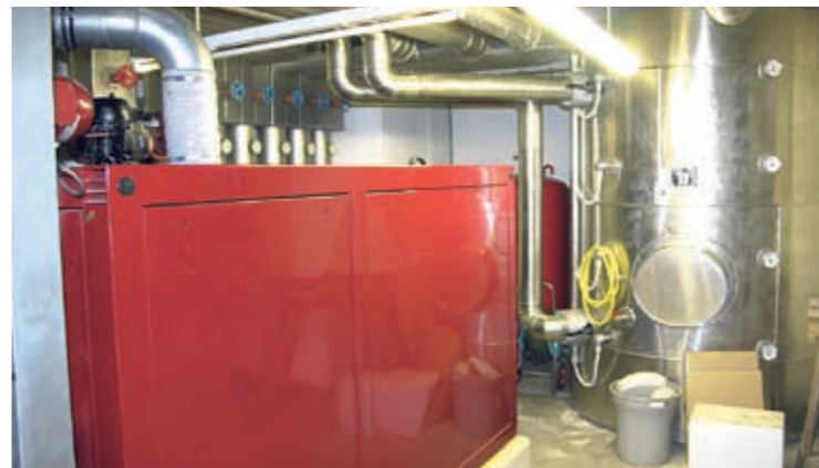
Mini-BHKW: Die Kieler Stadtwerke haben in der Schwentinentaler Astrid-Lindgren-Grundschule ein Blockheizkraftwerk aufgestellt, das durch die umweltschonende Kraft-Wärme-Kopplung gleichzeitig Strom und Wärme erzeugt.
