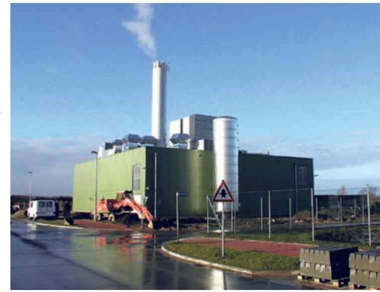
Das Blockheizkraftwerk im Flintbeker Gewerbegebiet an der B4: Dezentrale Kraft-Wärme-Kopplung, die mit Blockheizkraftwerken betrieben wird, bietet sich in Umlandgemeinden an.
