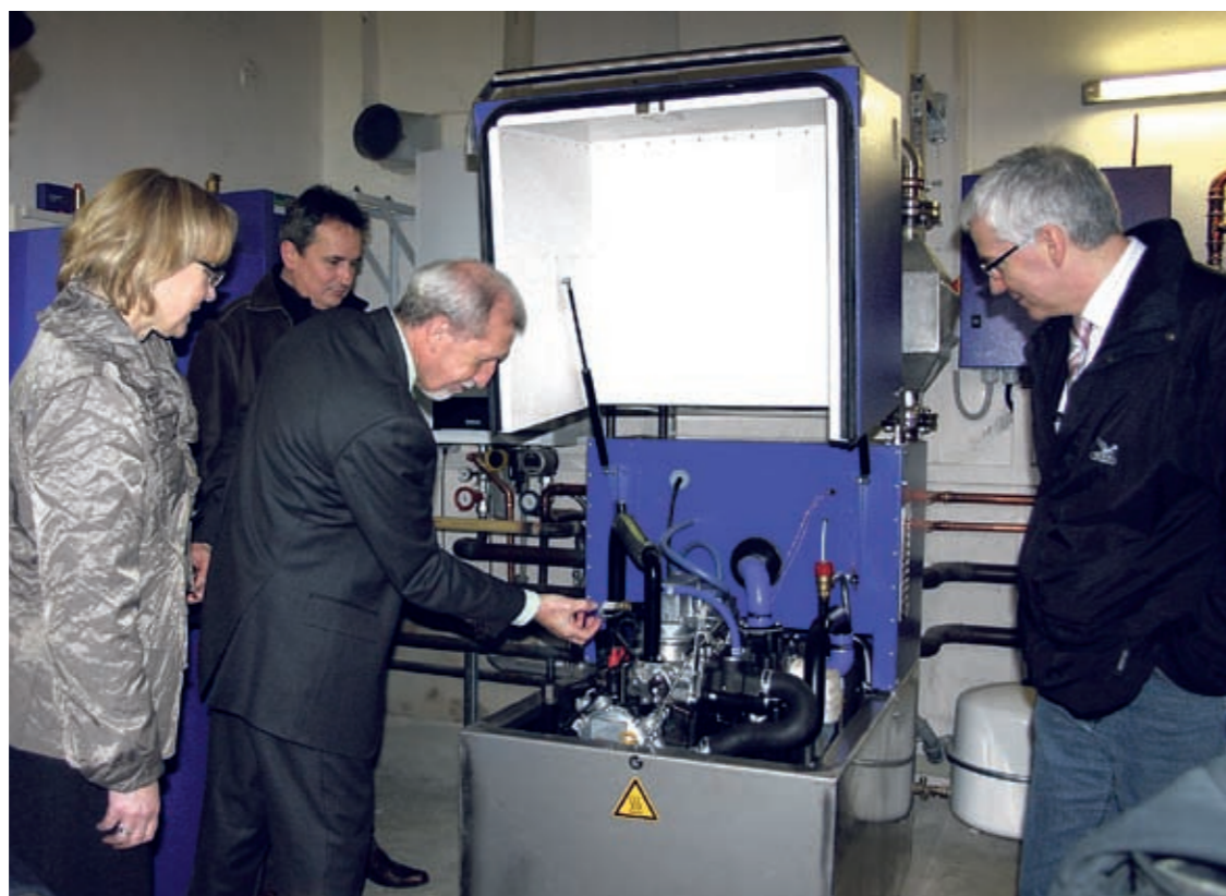
Nahmen das neue BHKW in Holtenau in Betrieb (von links): Andrea Gemmer, Schule Holtenau, Roger Mayer, Geschäftsführer der SW Erzeugung GmbH, Arthur Bächle, Technischer Vorstand Stadtwerke, und Bürgermeister Peter Todeskino.
