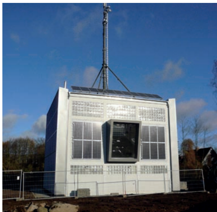
Das neue Blockheizkraftwerk Projensdorf versorgt das Neubaugebiet umweltschonend mit Energie.
